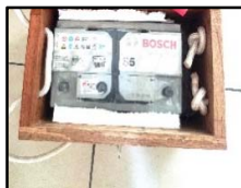
Fig. 08: Batería 12 voltios (Marca Bosh)
