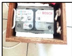
Fig. 08: Batería 12 voltios (Marca Bosh)
