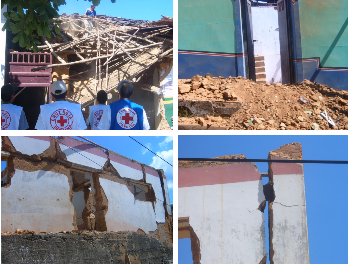
Figura 14: Daños en viviendas de tapial, distrito de Lamas
